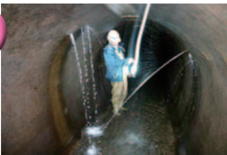
トンネルからの漏水状況
