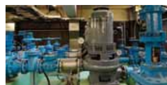
師崎送水ポンプ場 (上:外観 下:ポンプ施設等)
