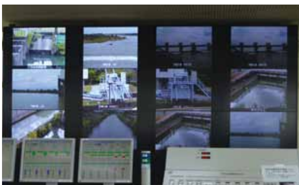
カメラによる監視
