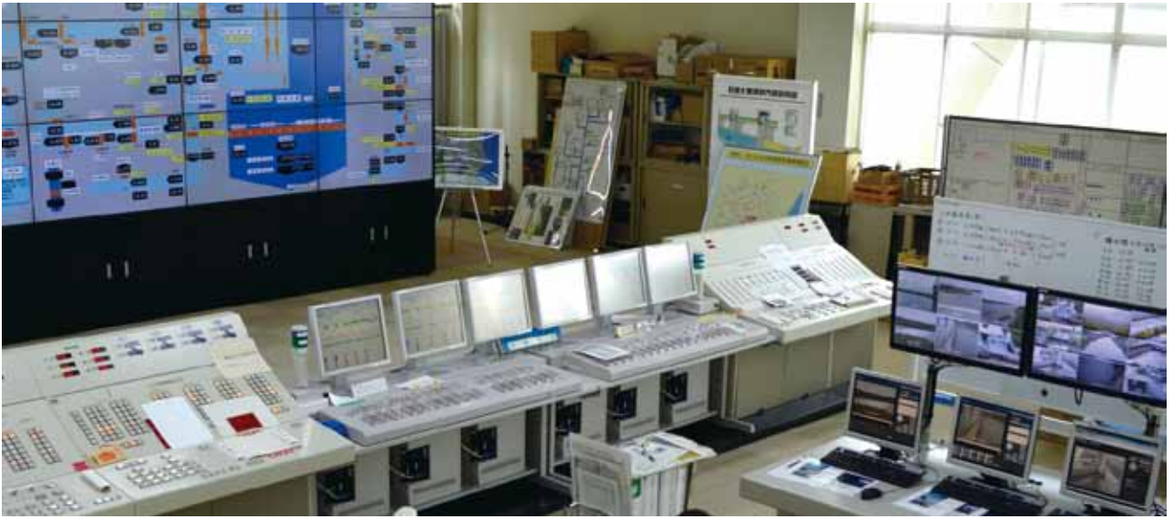
利根導水総合事業所操作室
