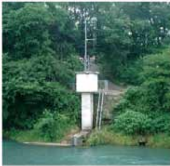
河川水位観測局舎
