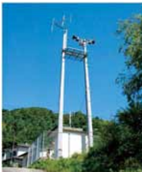
放流警報設備
