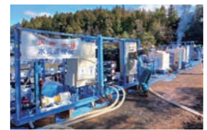
可搬式浄水装置全景
