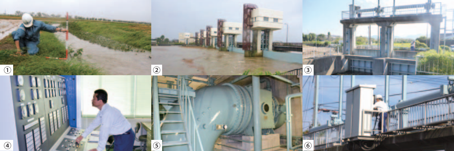
①低標高農地・水路の調査 ②全開した大同川水門 ③全開した今江川樋門 ④水門操作の様子 ⑤大同川排水機場のポンプ ⑥来向川樋門操作状況
