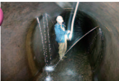
トンネルからの漏水状況
