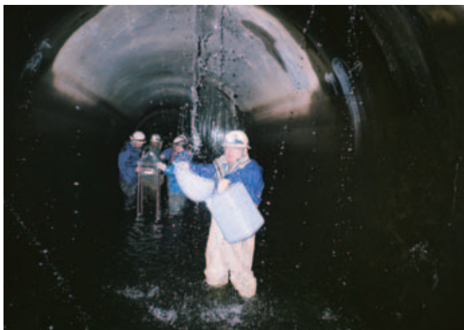
有馬トンネルの浸入水
