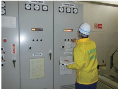
受変電設備の動作確認 (早明浦ダム)
