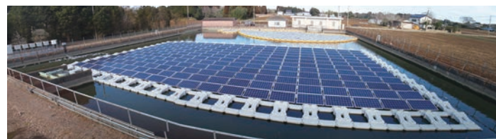
太陽光発電設備(北総東部用水)
