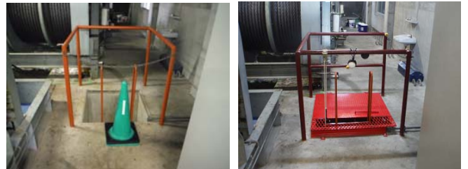
写真-1 鋼製蓋の未設置（写真左）と設置後（写真右）
