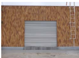
写真-1 横芝揚水機場既設給気ガラリ
