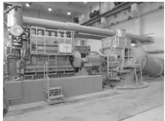
図-1 糠田排水機場ポンプ設備
