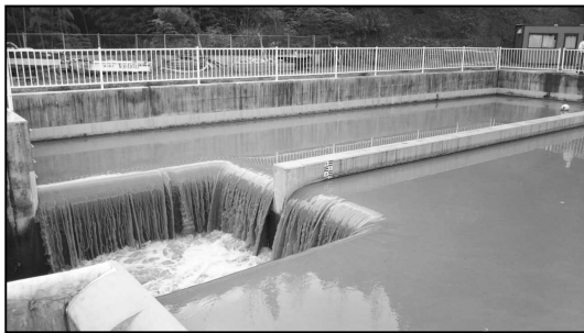
写真-2 神淵沈砂池高濁度状況
