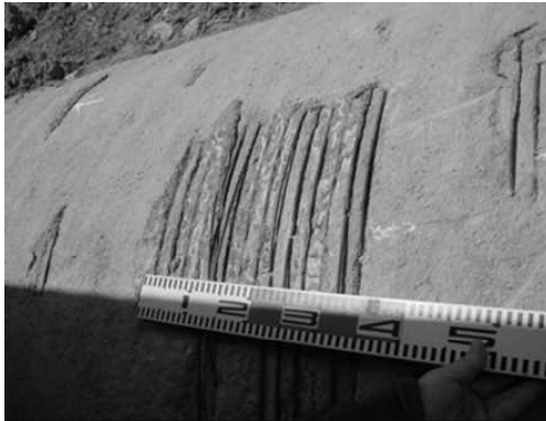
写真-1 高瀬支線水路 PC管劣化状況
