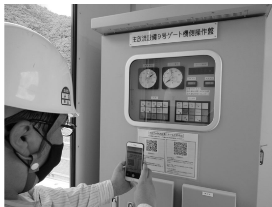
写真-2 機側操作盤での読取状況
