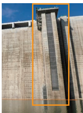
選択取水設備（川上ダム）
