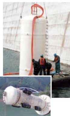
設備の設置状況
