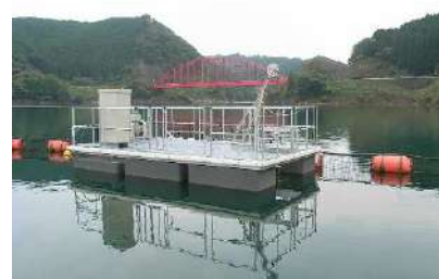
写真 5.3 水質自動観測設備（青蓮寺ダム）
