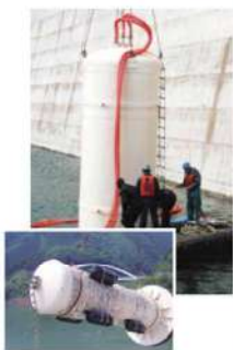
設備の設置状況
