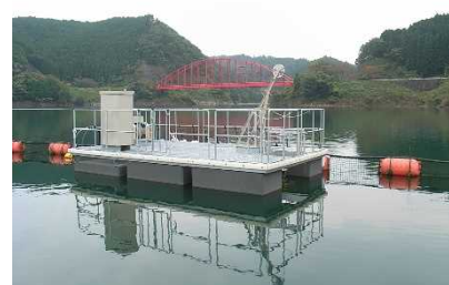
写真 5.3 水質自動観測設備（青蓮寺ダム）
