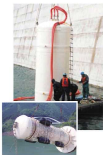
設備の設置状況
