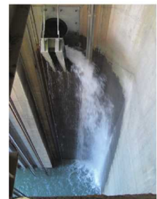
バイパス水路の吐出口
