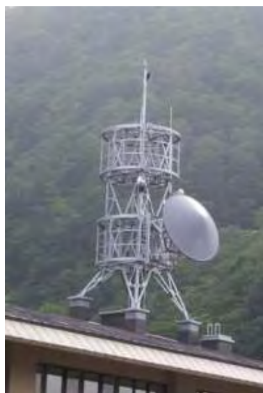
通信設備写真 (他ダム事例)
