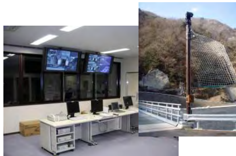
映像監視設備写真 (他ダム事例)
