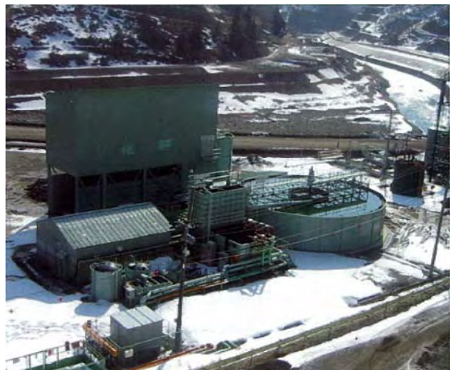
写真 2.4-1 濁水処理施設の例
