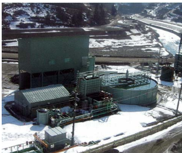
写真 2.4-1 濁水処理施設の例
