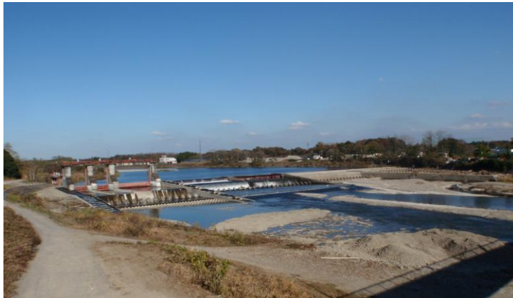
写真 2.2-7 大光寺堰（美田東部頭首工）
