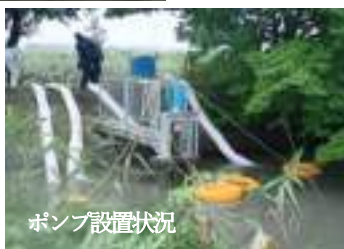
ポンプパッケージ現地到着
