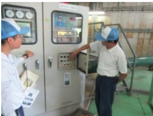
放流設備操作訓練状況
