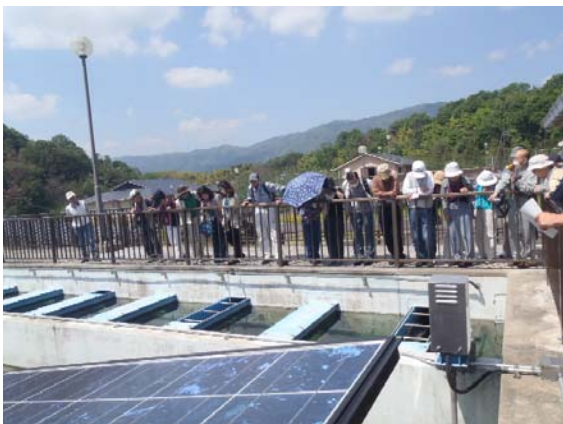
（乙訓浄水場「太陽光発電システム」）
