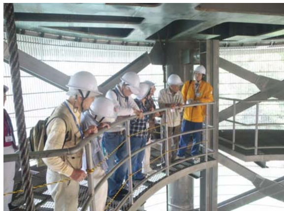
（日吉ダム「選択取水設備」内部の様子）
