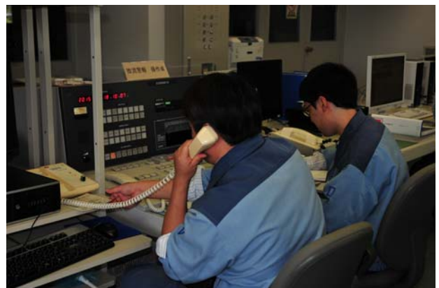
ゲート操作前のスピーカ・サイレンによる放流警報
