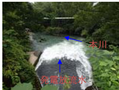
⑥新庄発電所 放流口
