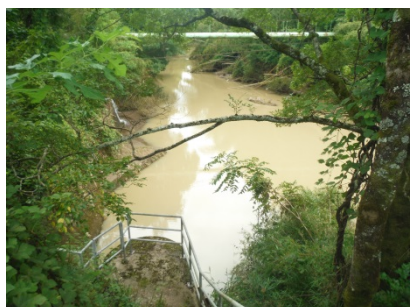
⑥新庄発電所 放流口(停止中)
