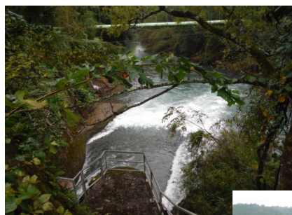
⑥新庄発電所 放流口(運転中)
