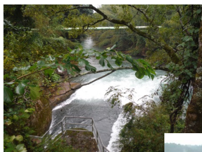
⑥新庄発電所 放流口(運転中)
