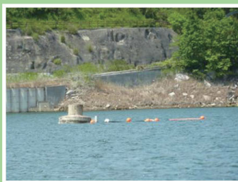
④ 深層曝気設備
