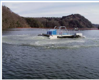
① 浅層曝気循環設備
