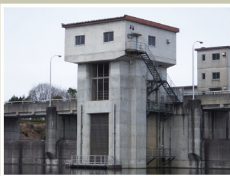
③ 選択取水設備
