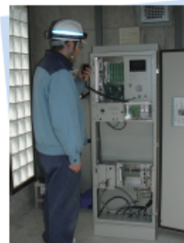
放流警報設備更新(職員による機能確認) 【比奈知ダム】
