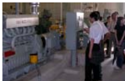
排水ポンプ設備
