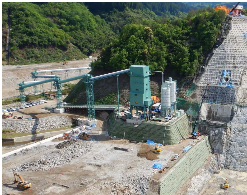
コンクリート製造設備
