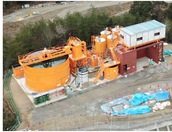
濁水処理設備
