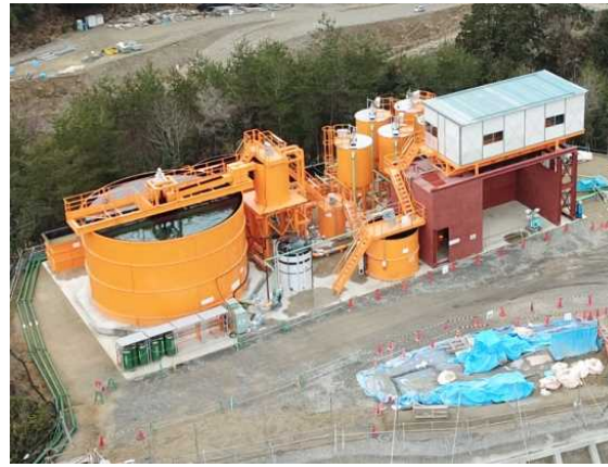
濁水処理設備
