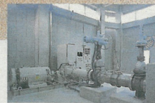
管理用発電設備 (せせらぎ水路放流設備)
