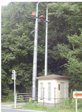
サイレン・スピーカー警報所
