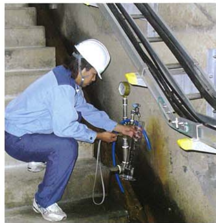
漏水量の観測
