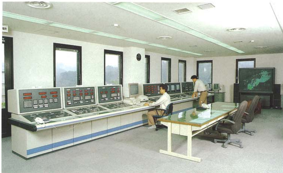
ダム管理所操作室
