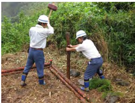
本柵設置状況
