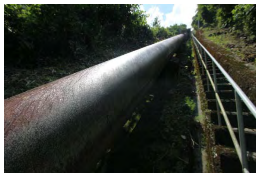
発電機へ水を送る鉄の管
