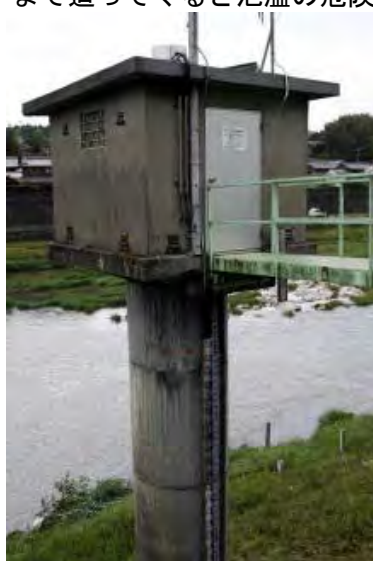
島ヶ原にある量水標とフロート式水位計（塔内）
