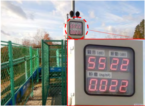
騒音・振動・粉じん計測装置(ダムサイト右岸天端)
