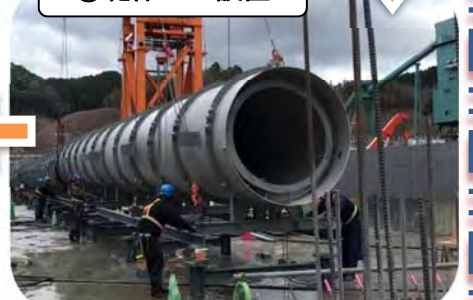
④堤体上に設置
