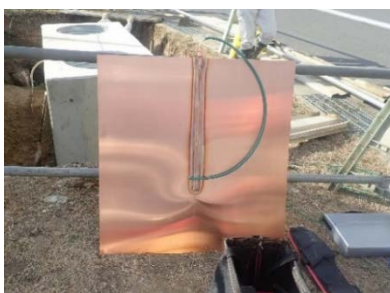
接地工事に使用した銅板
