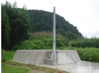
放流警報設備のコンクリート基礎
