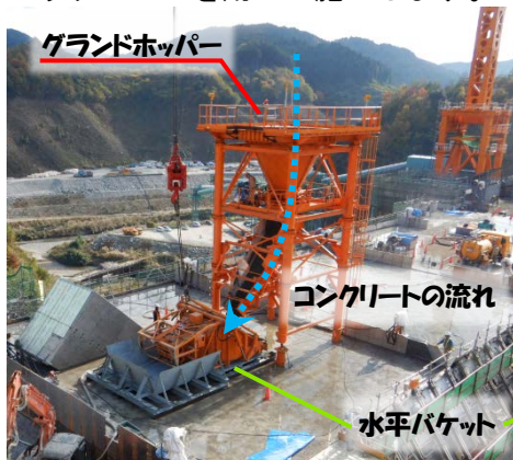
グランドホッパーから水平バケットへコンクリートを移すようす
