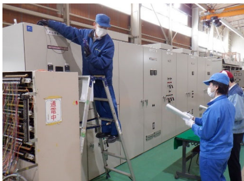
受変電設備 (工場検査)
