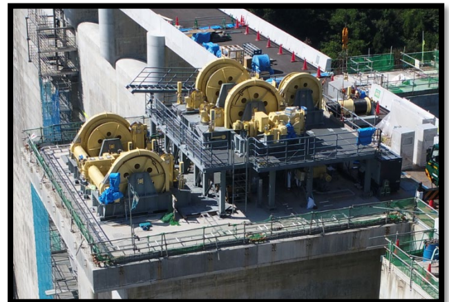
選択取水設備開閉装置のようす（9月時点）
