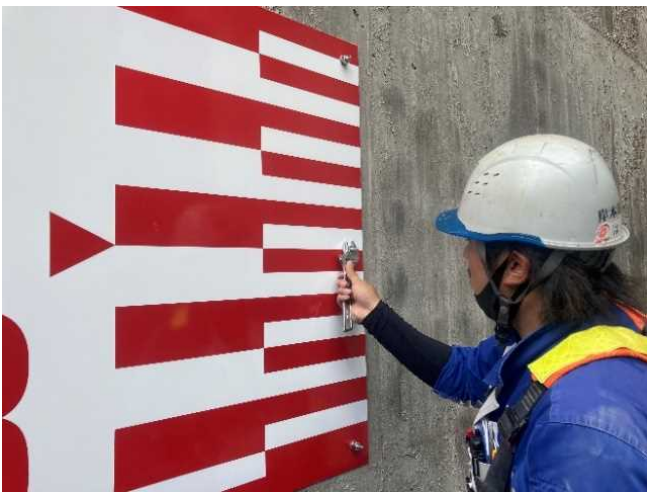
量水標設置の状況
