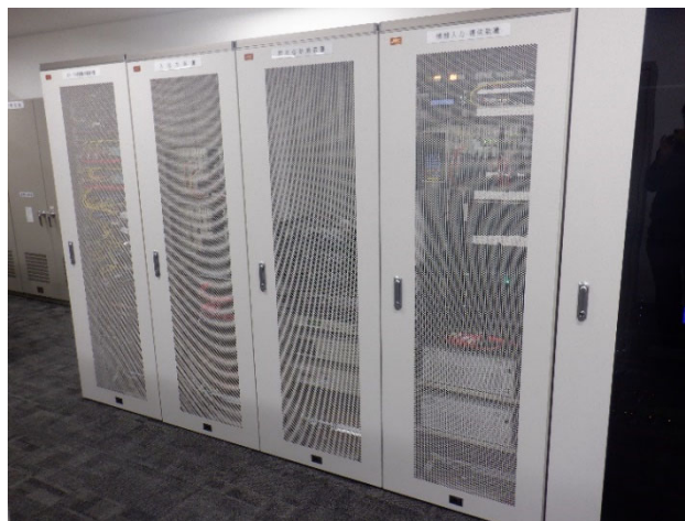
ダムコン(無線装置)
