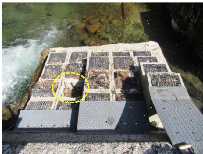
写真 4-14 破損した遡上路(黒淵井堰)
