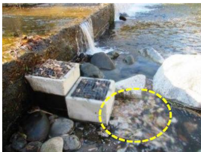
写真 4-15 破損した遡上路(百合の口井堰)
