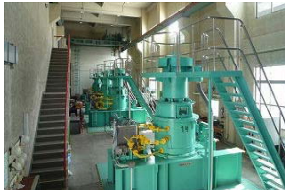
高見機場（ポンプ設備）
