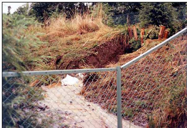
●高時川右岸 錦織地区の堤防崩壊状況
