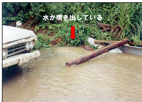
●堤防からの湧水状況
